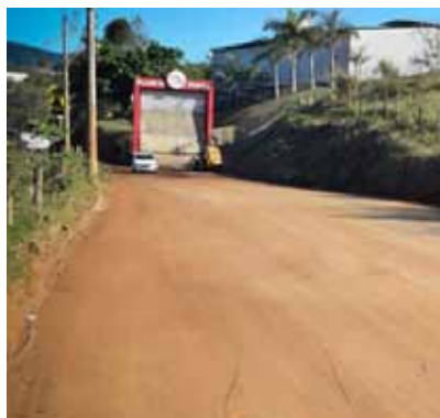
Local estava bastante danificado; obra beneficia empresas e moradores do distrito
