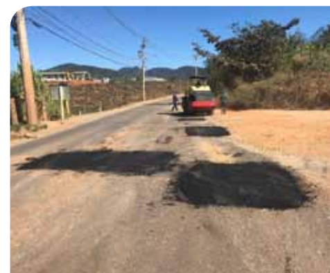
A Secretaria de Obras já iniciou uma operação para reparo na pavimentação no acesso à localidade
