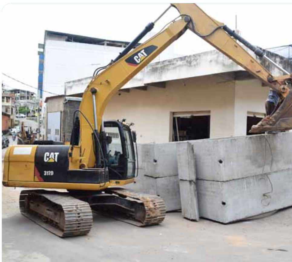
A antiga rede, danificada há cerca de oito anos, causava diversos problemas
