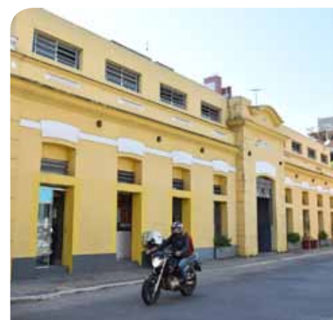
A ação marca o início de uma série de melhorias no prédio, inaugurado há 98 anos
