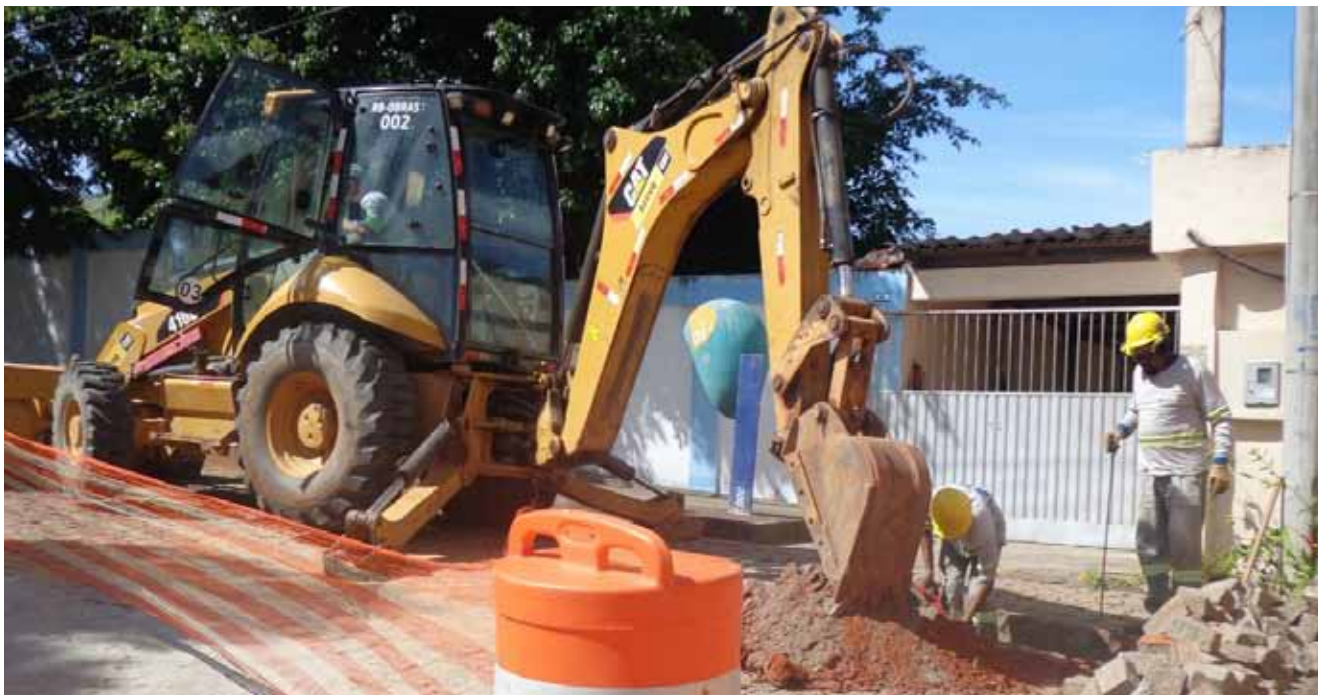
Proprietários de imóveis que não puderem ser ligados compulsoriamente à rede de esgoto serão notificados
